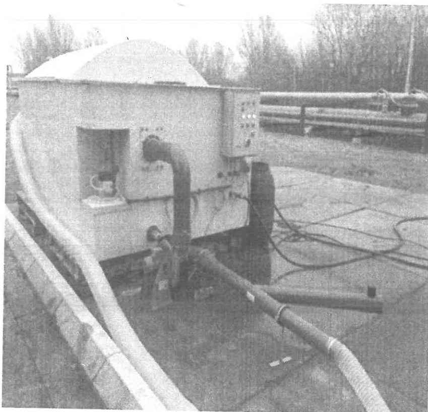
Prezentare Biofiltru pilot station – pentru testare
