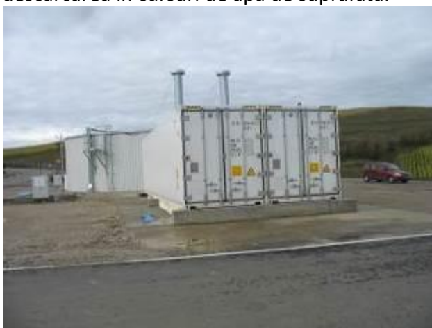
Foto 11 – DDN Sanpaul. Containerele Stației de Epurare Levigat (RO)
