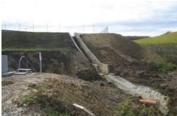
Foto 12 – DDN Sanpaul. Descarcatorul bazinului pluvial / permeat
