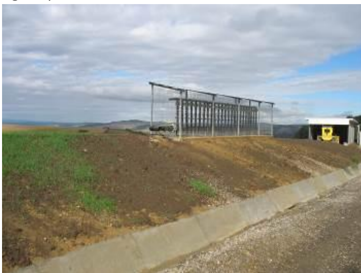
Foto 3 – Celula 1 a DDN Sanpaul. Substatia de biogaz
