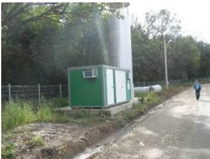
Foto 4 – Celula 1 a DDN Sanpaul. Facla de biogaz
