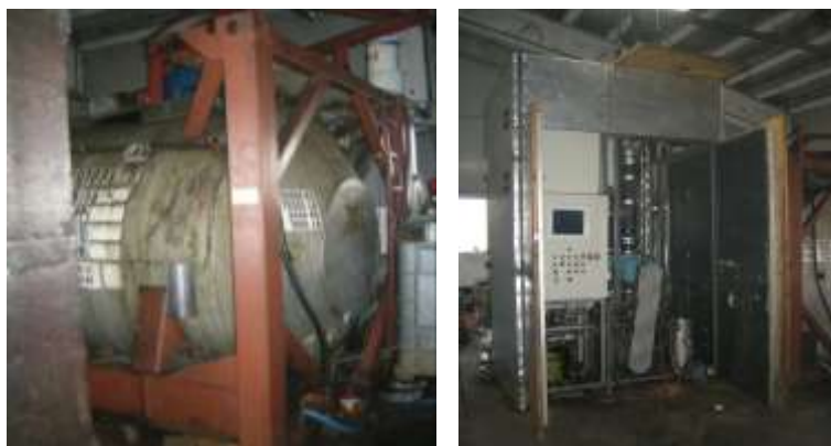
Fig. nr.3. Instalația de tratare emulsii
