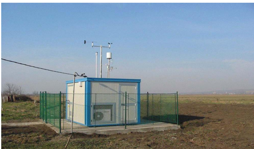
Stația de monitorizare a influenței industriale MS – 2
