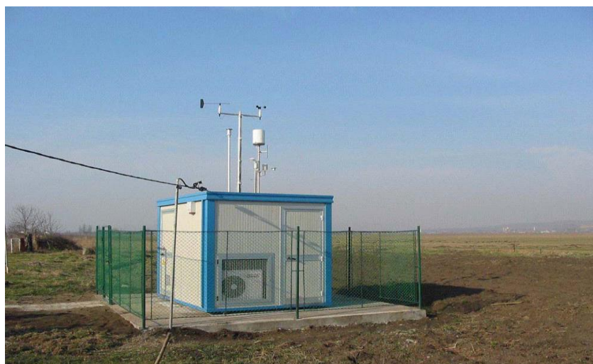
Stația de monitorizare a influenței industriale MS - 2
