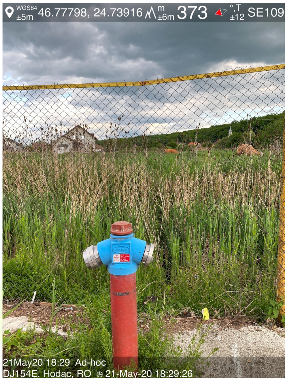
Figura nr. 40 Hidrant exterior in zona SudEstica a Depozitului de Material Lemnos
