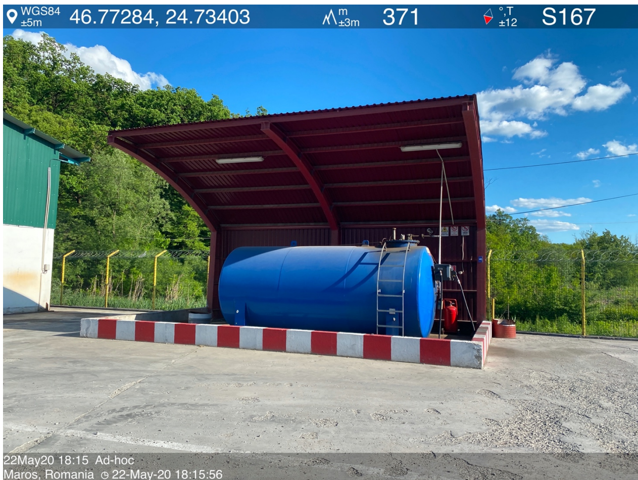
Figura nr. 55 Zona de amplasare a rezervorului de motorina, cuva de retentie pozitionata supratcran pe platforma betonata
