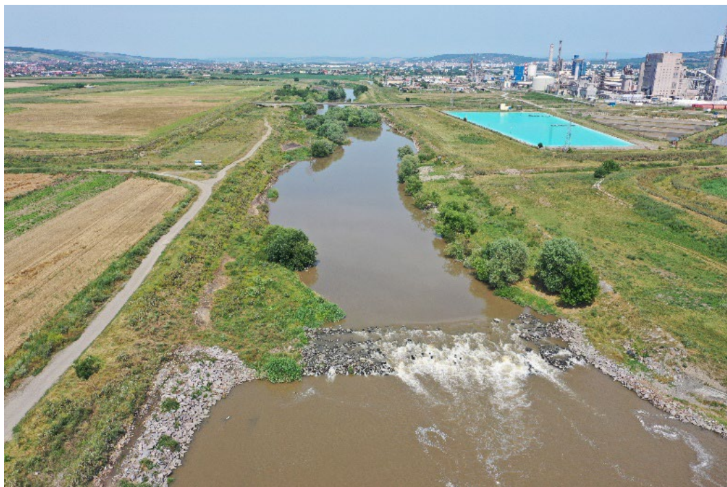
Vedere prag 2 avariat – se observă pragul avariat și o veche lucrare cu traverse CF pentru stabilizarea pragului, debitele fiind dirijate spre malul stâng;
