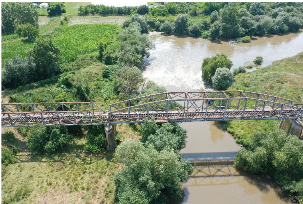
Vedere prag amplasat pe râul Mureș amonte d pod CF Cristești, cu breșa dezvoltată din mijloc spre malul stâng, cu deschidere de cca. 22 m.
