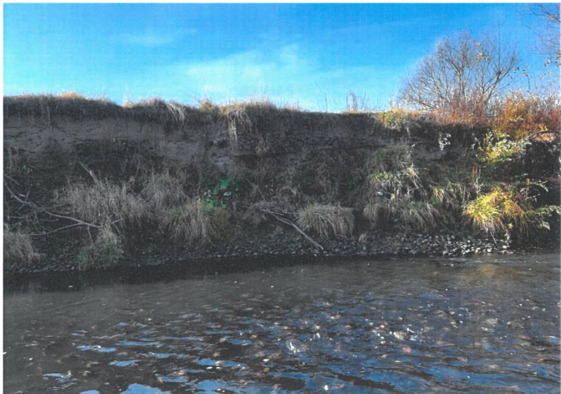
Foto 2 – Râu Târnavă Mică, loc. Trei Sate – vedere spre mal stâng (aparare de mal deteriorate)
