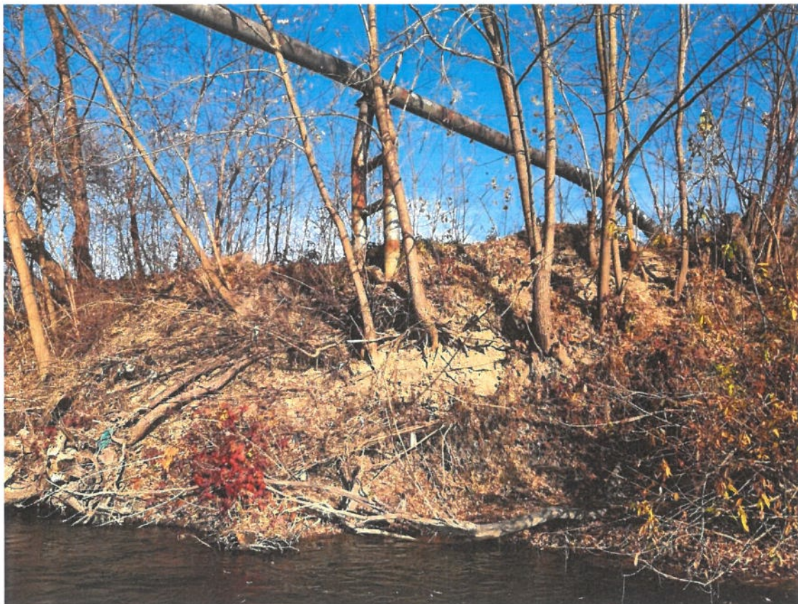
Foto 3 – Râu Târnavă Mică, loc. Trei Sate – mal drept erodat
