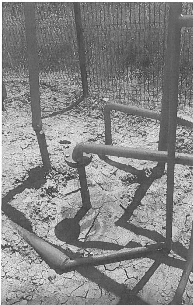
Zona de montaj a instalatiei de liftare
